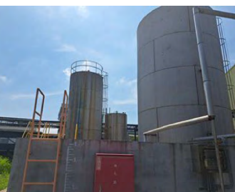
甲醛儲槽區 (未波及)
