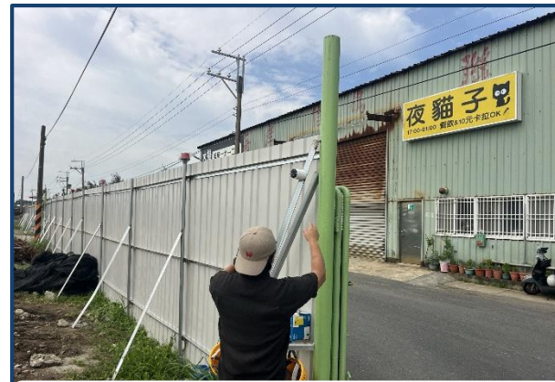
工區出入口設置CCTV
